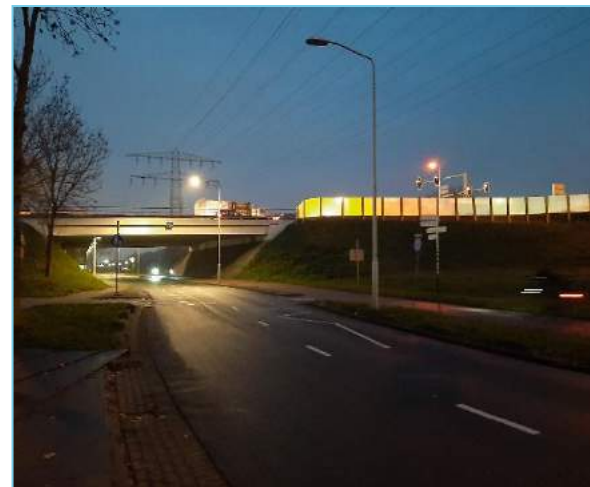
Figuur 21: Defecte lichtmast ter hoogte van oversteekplaats.
