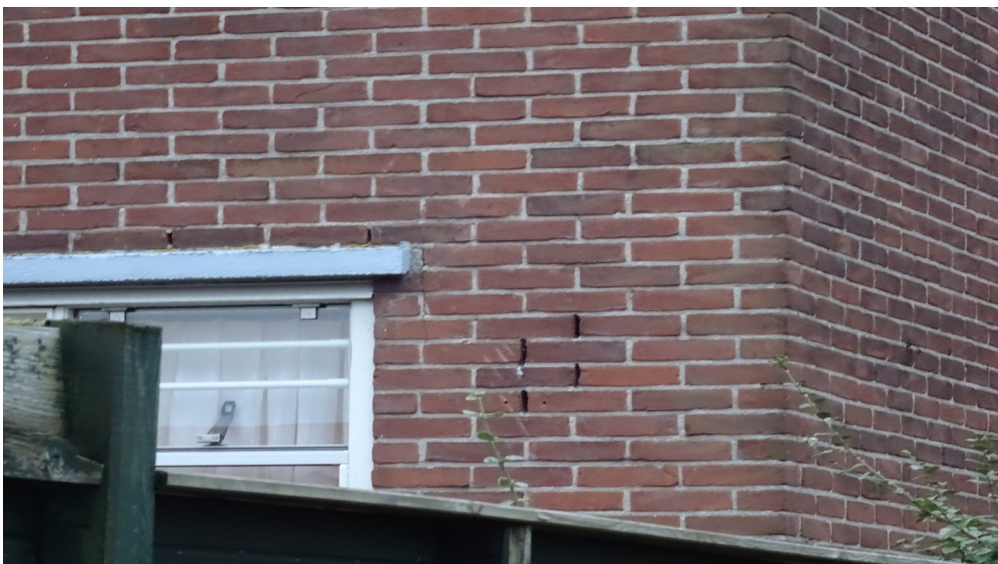
Open stootvoegen in de bebouwing toegankelijk voor vleermuizen. Foto: K.J. van veen | Ecoresult B.V.
