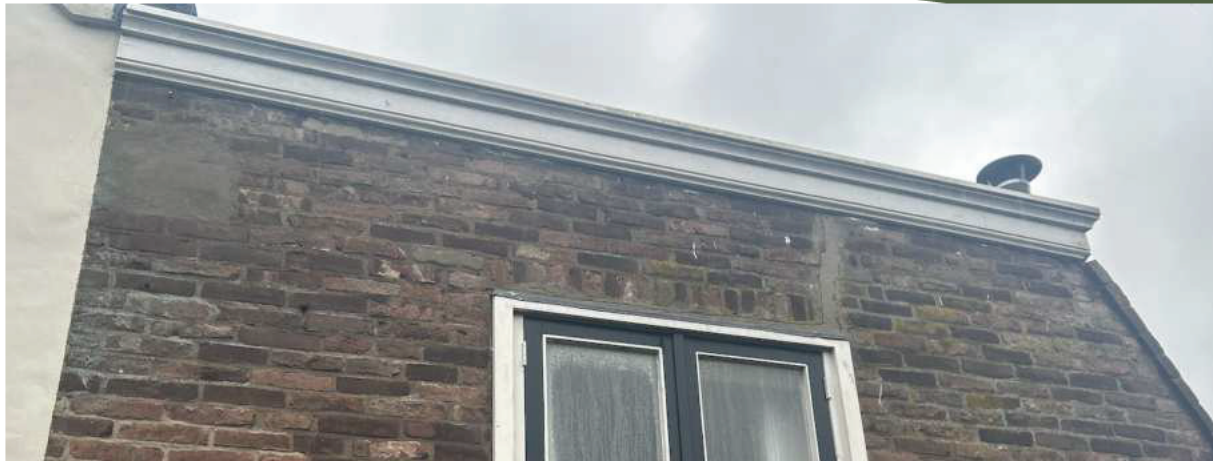
F guur 12: ontbreken gesch kte ru mtes onder dakrand
