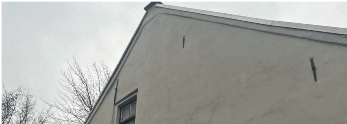
F guur 13: ontbreken gesch kte ru mtes onder dakrand
