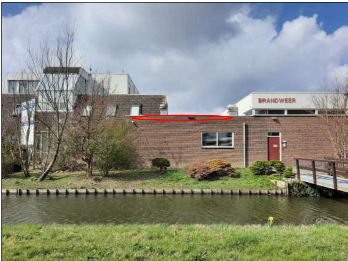
Figuur 4: Open stootvoegen in de te slopen bebouwing.
